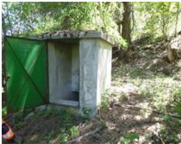
◆ Captage de Rochasset
