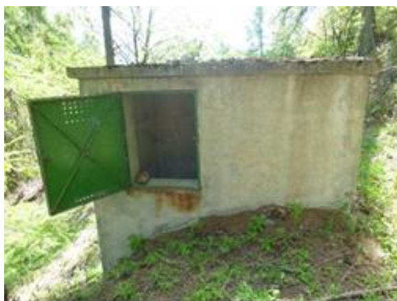
◆ Captage de Rocher Blanc
