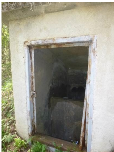
◆ Captage de Clot du Borre
