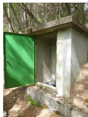
Captage du Bessey
